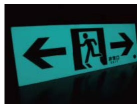
避難誘導標識
